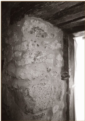
Detalle del muro medianero que separaba los dos ambientes de la casería Arroan Haundi. Setiembre de 2016.
