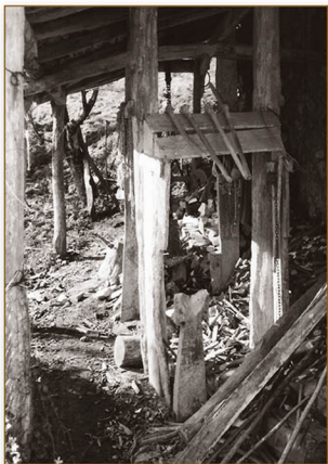
Perratoki o ferratoki para herrar ganado en la fachada lateral derecha del cobertizo que se ha conservado al lado de la casería Arroan Zaharra. Marzo de 1996.
