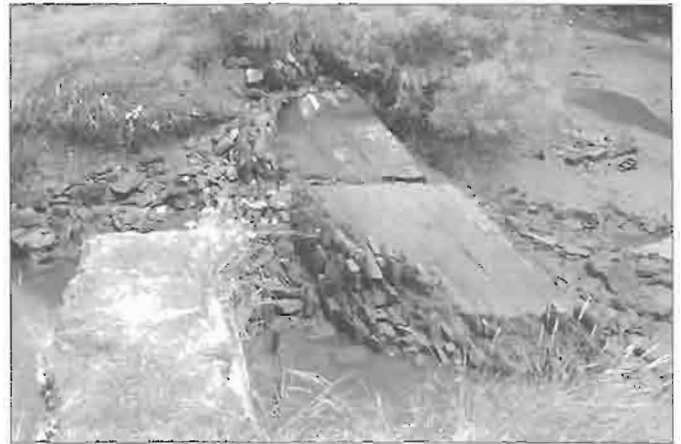
Detalle del muro abatido por la riada de 2005.
