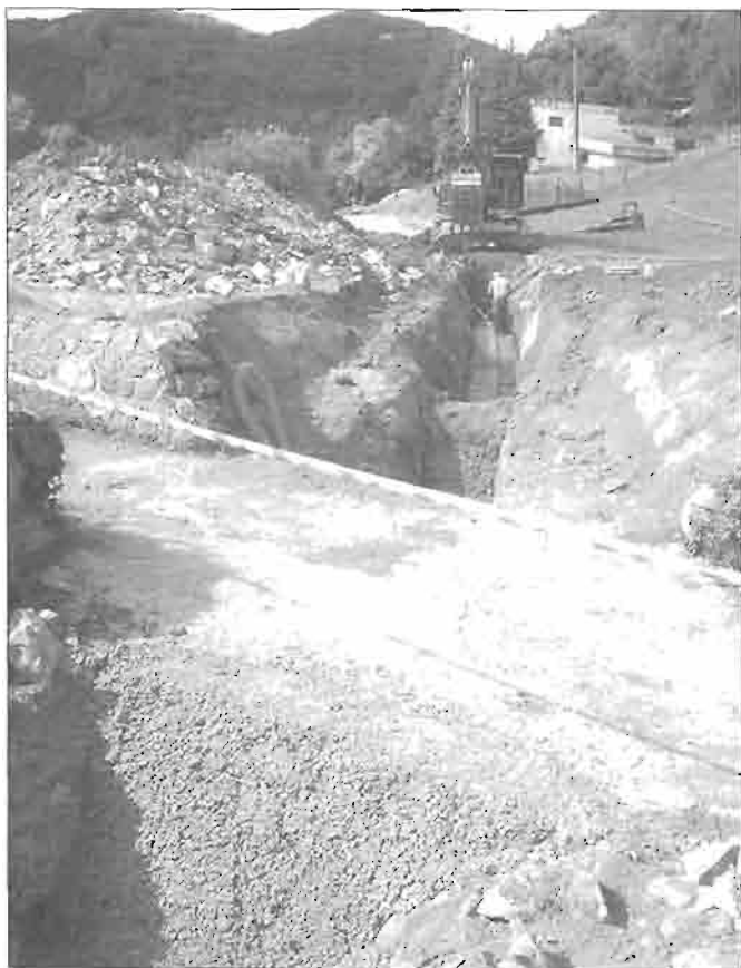
Se añade hormigón sobre la zanja y aquí no ha pasado nada (28-08-2006)
